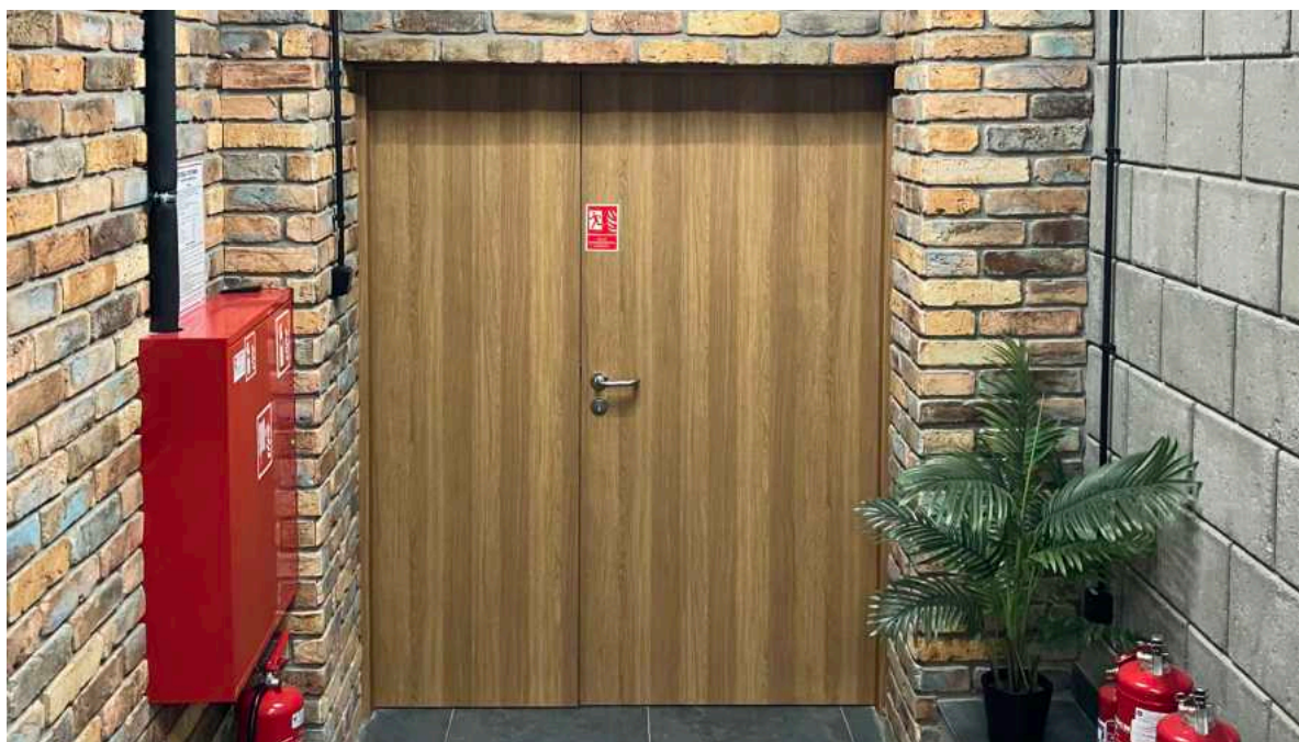
protipožární dveře FR EI30, pevná dřevěná zárubeň
