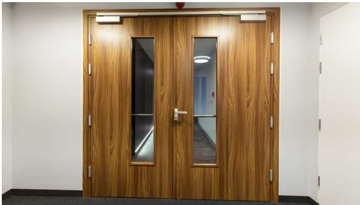
protipožární dveře FR EI30, pevná dřevěná zárubeň
